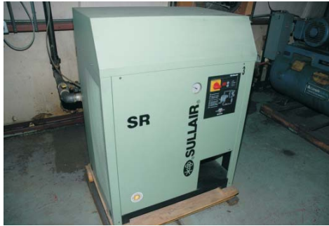
SULLAIR AIR DRYER
